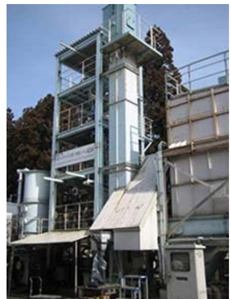
木質バイオマスプラント外観
