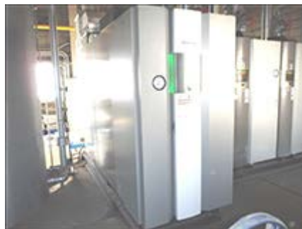
高効率ボイラーの導入
