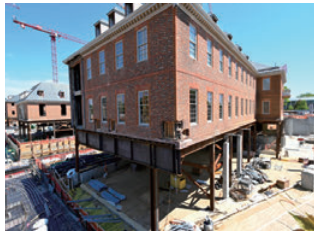
歴史的建造物を保存している様子
